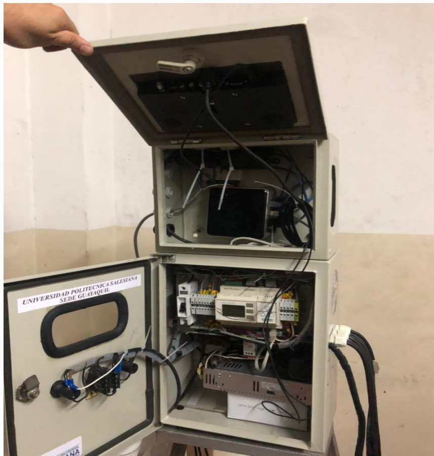
Figura 114. Conexión en red entre el industruino y la pantalla.
