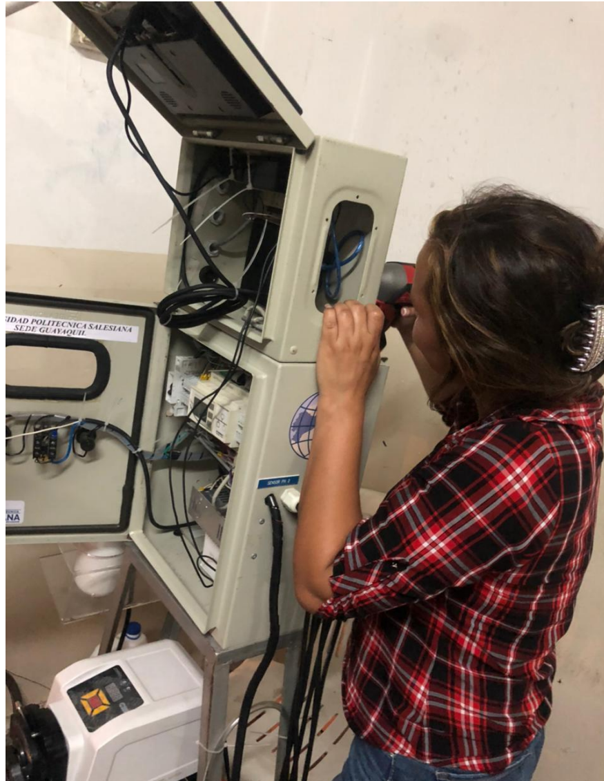
Figura 111. Acoplando PC al tablero.
