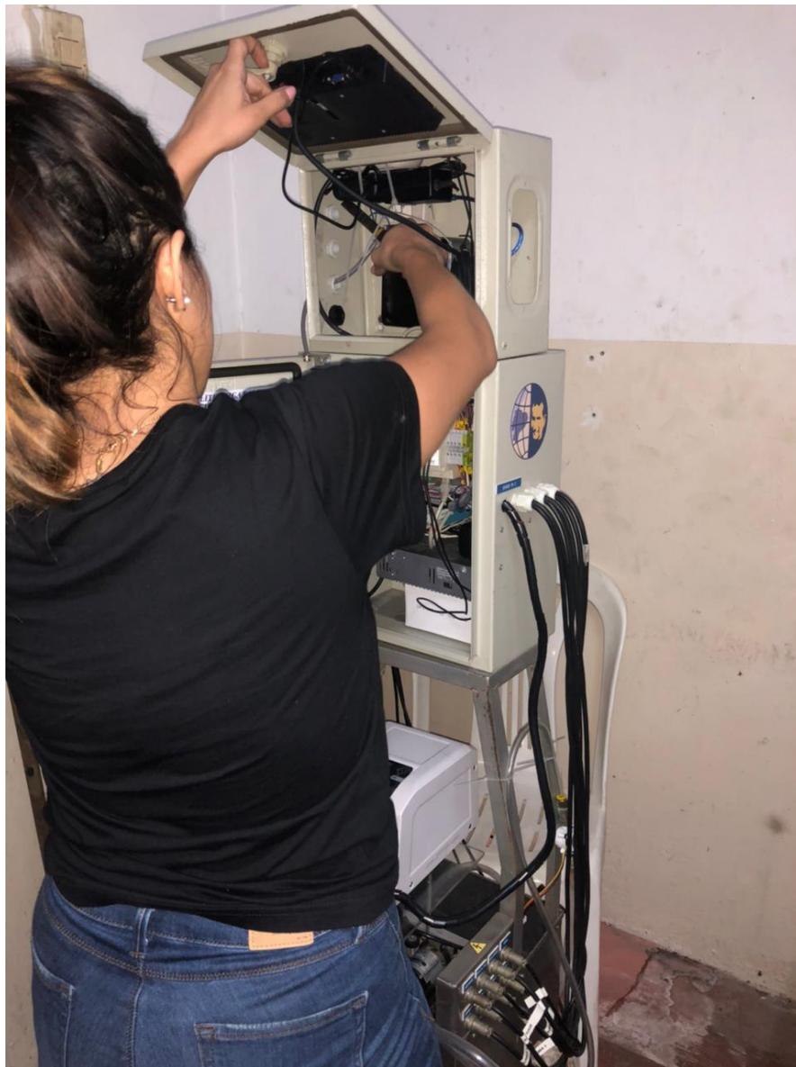
Figura 112. Posicionamiento y organización de componentes del tablero de control y de sus cables.
