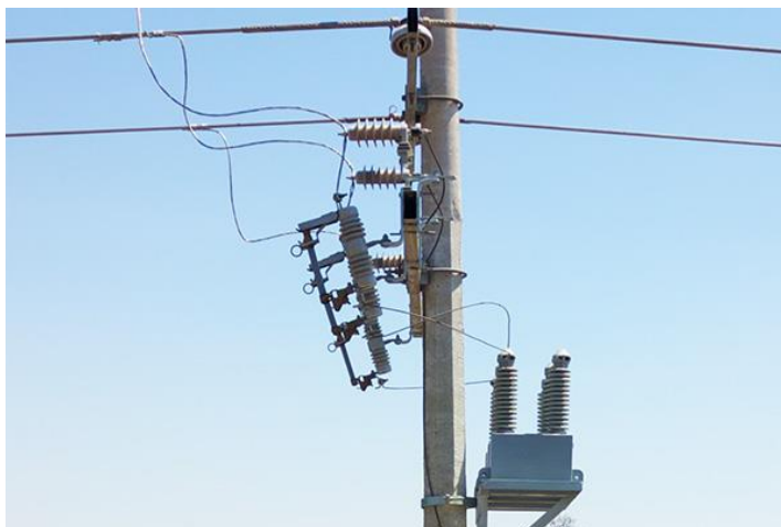
Figura 3: Banco de capacitores fijos de media tensión Fuente: www.eprecsa.mx
