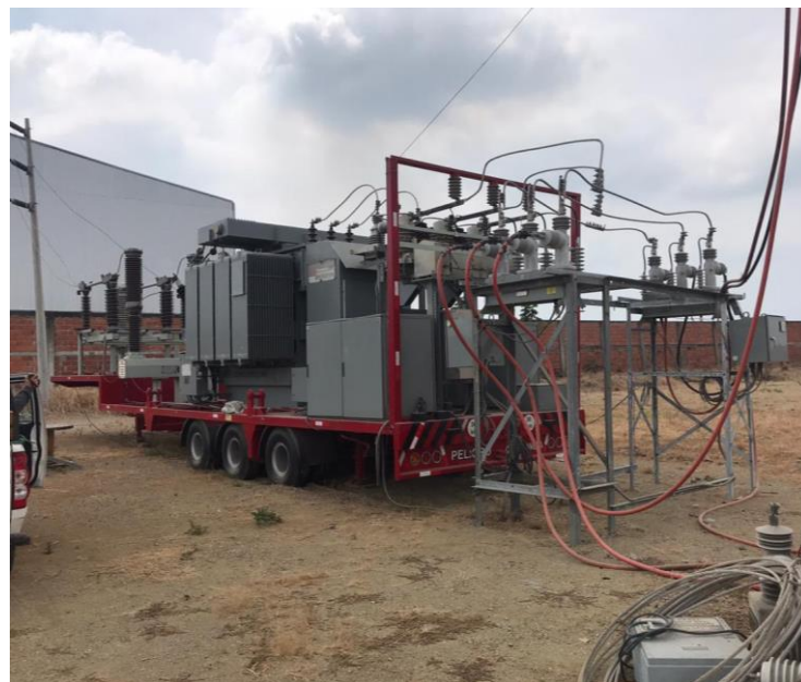
Figura 27: Alimentador 1 y Alimentador 2 de la subestación móvil Laurel Fuente: Autores
