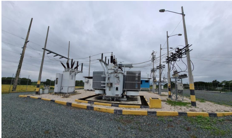
Figura 10: Subestación Santa Lucia Fuente: Autores
