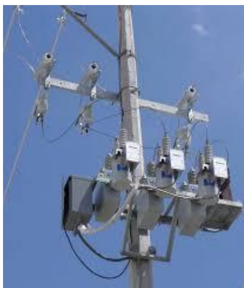
Figura 4: Banco de capacitores automático en media tensión Fuente: www.artech.com .
