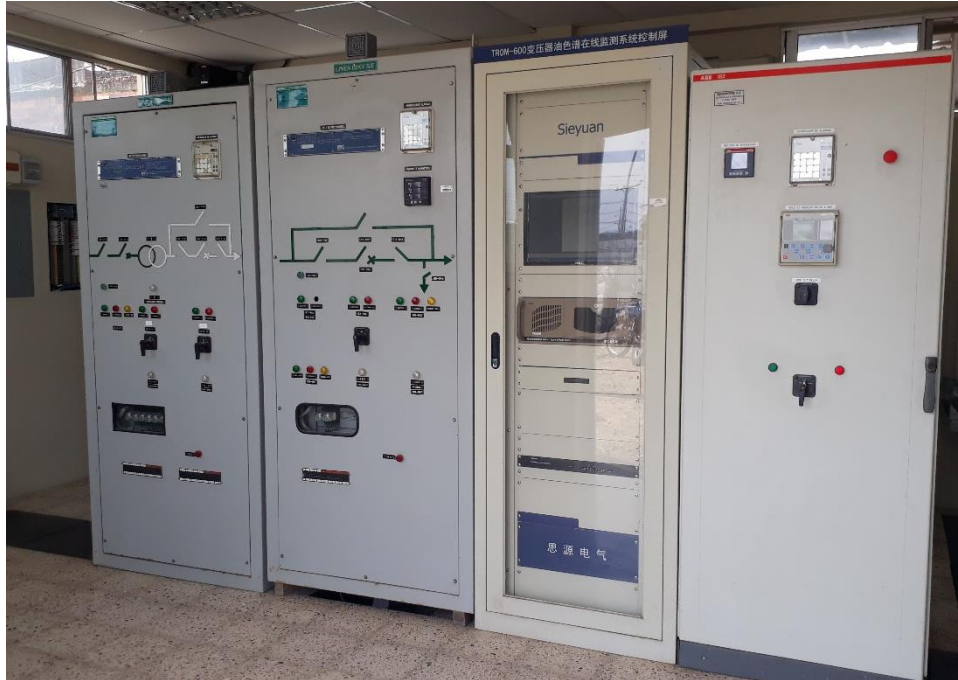
Figura 33 Cuarto de Control de la Subestación Daule Norte Fuente: Autores
