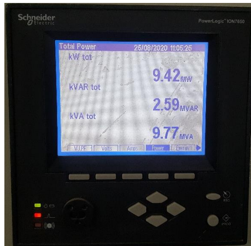
Figura 14 Medidor ion instalado en la subestación Daule Sur Fuente: Autores
