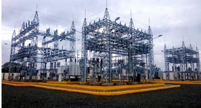
Figura 4 Subestación eléctrica Puerto López Fuente: Gobernación de Manabí
