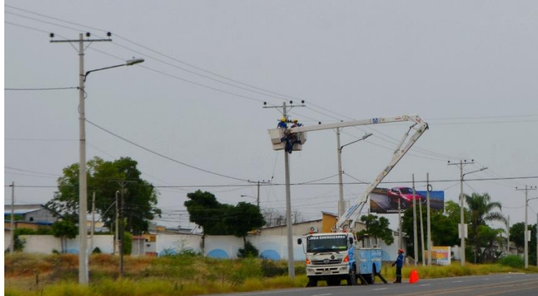
Figura 6 Alimentador Trifásico aéreo Fuente Cnel Ep
