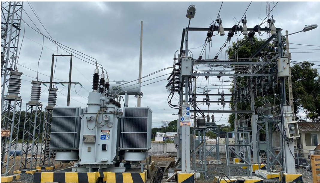
Figura 13 Subestación Daule Sur – Bahía de 13800 voltios Fuente: Autores
