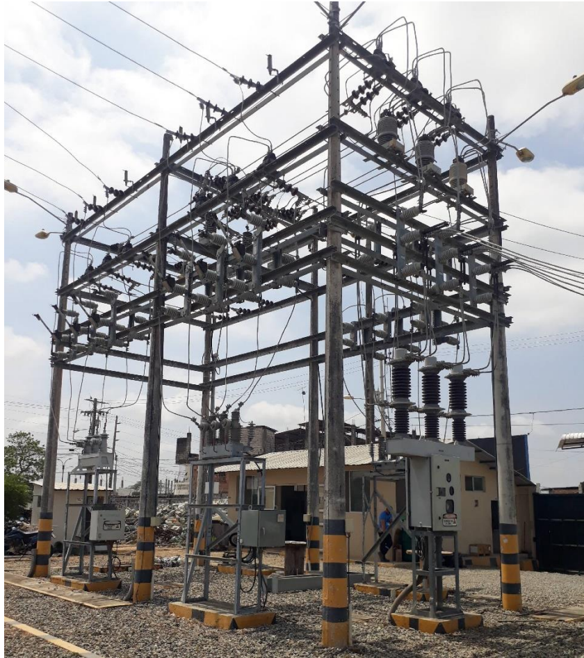
Figura 32 Subestación Daule Norte – Bahía de 13800 voltios Fuente: Autores
