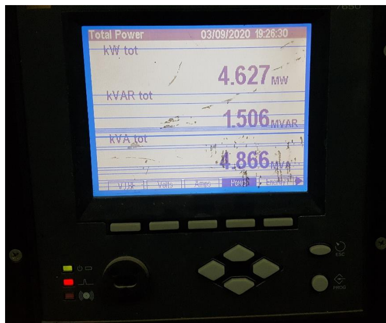
Figura 34 Medidor ion instalado en la subestación Daule Norte Fuente: Autores
