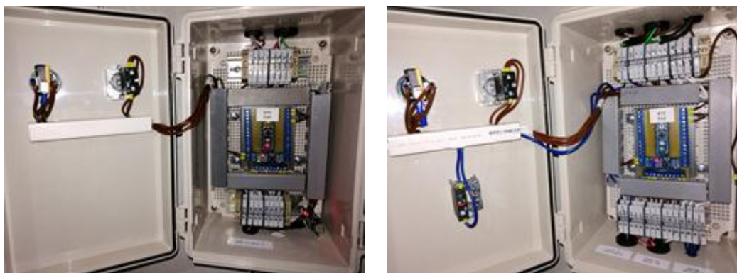
Ilustración 50. Tableros eléctricos de Tanque 2 y Estación 2
