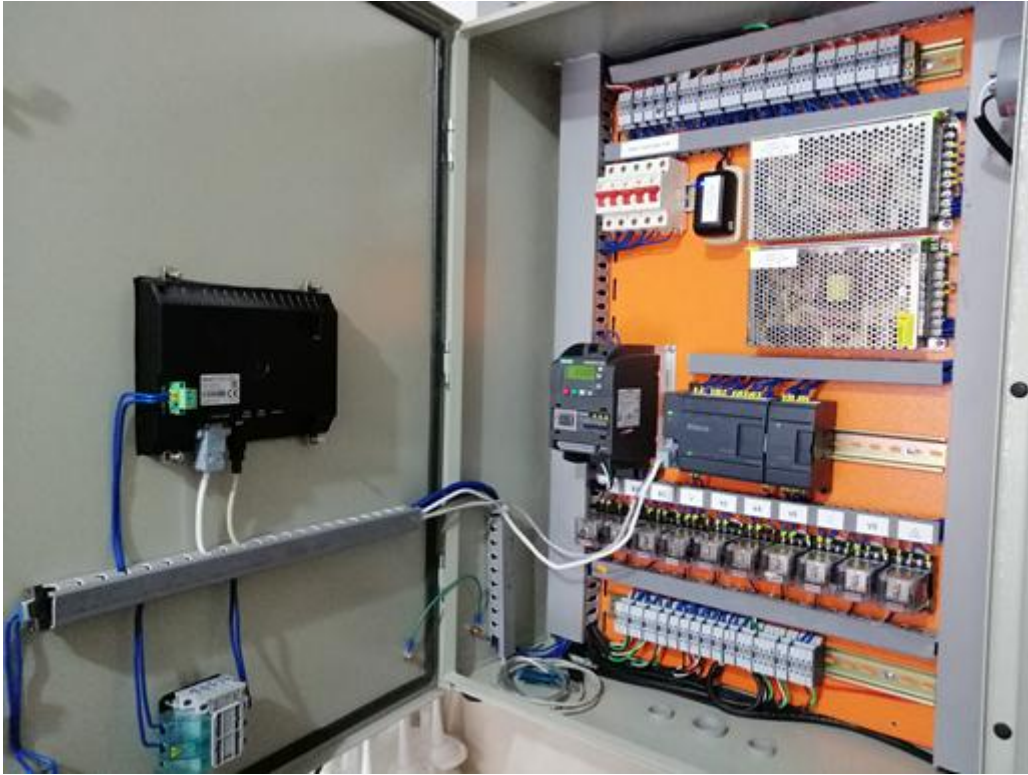
Ilustración 48 Tablero de estación de control general del sistema
