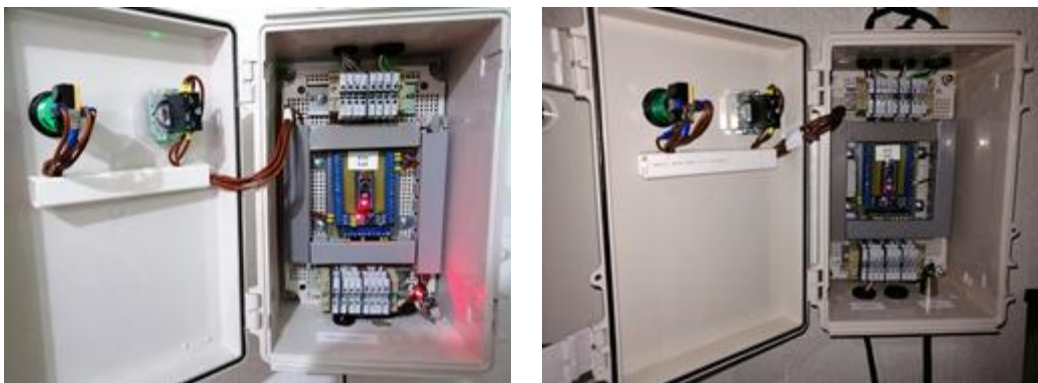
Ilustración 49. Tableros eléctricos de Tanque 1 y Estación 1
