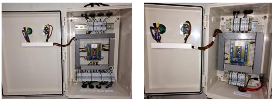
Ilustración 51. Tableros eléctricos de Tanque 3 y Estación 3
