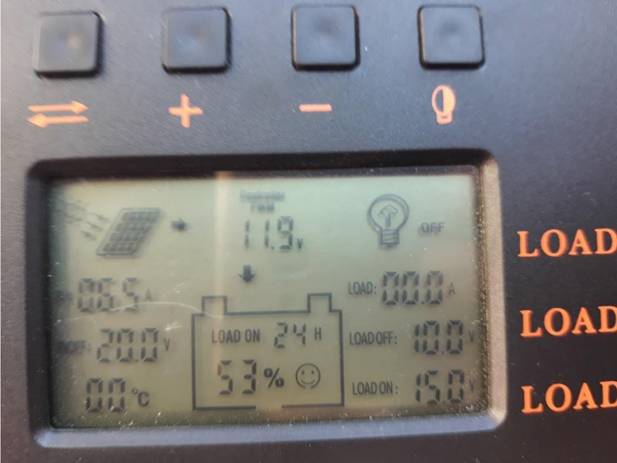
Figura F Información de controlador de corriente de paneles solares
