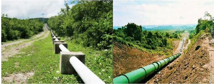
Figura 21. Tubería en línea de conducción por gravedad [20].
