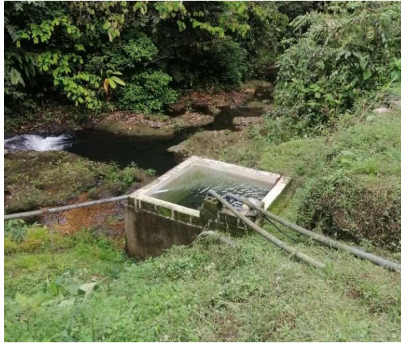
Figura 30. Tanque de captación.
