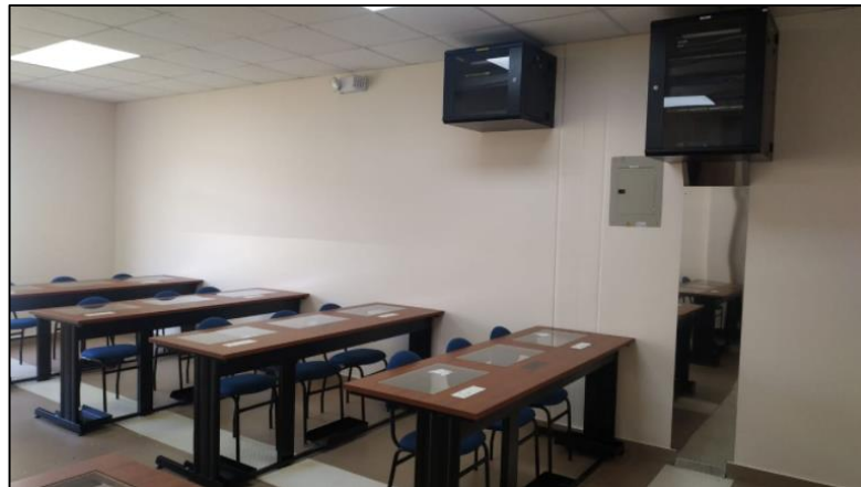
Figura 21. Nuevo laboratorio de protecciones eléctricas. Fuente: El autor.
