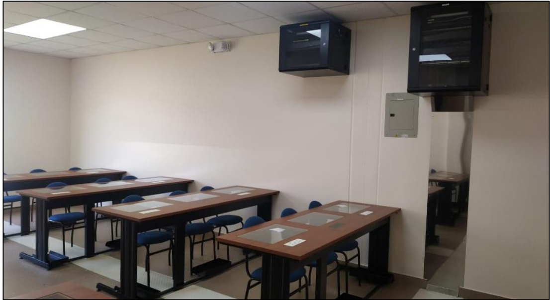
Figura 98. Nuevo laboratorio de protecciones eléctricas. Fuente: El autor.
