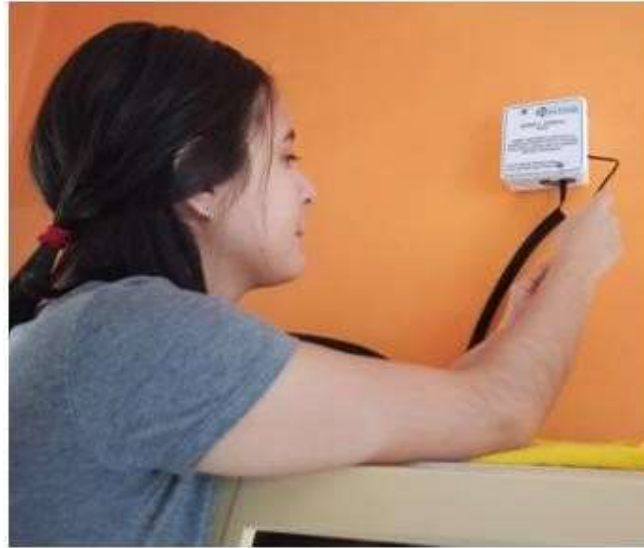
Figura 26 Instalando el sensor 2 – comedor Fuente:
