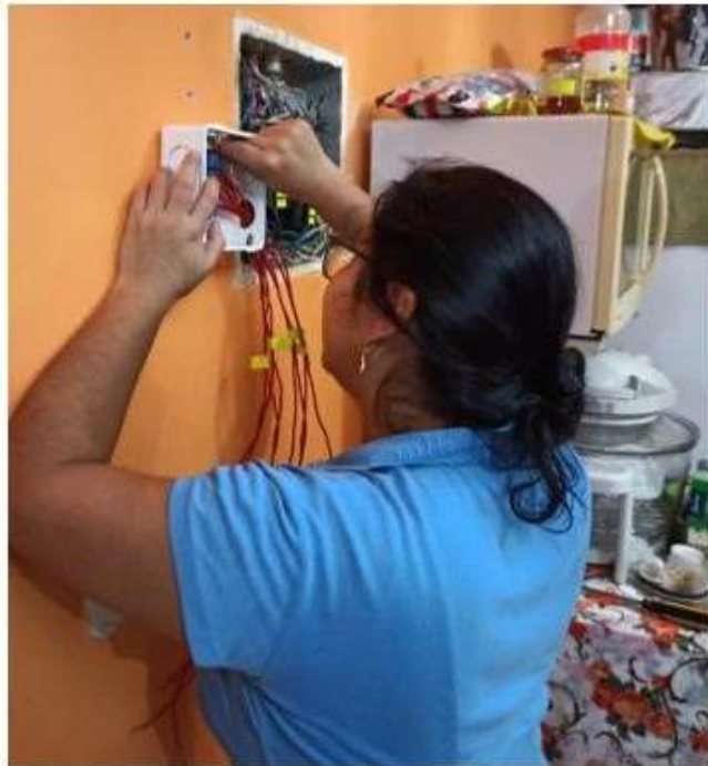
Figura 102 Instalando el relé a lado de la caja de los breakers.
