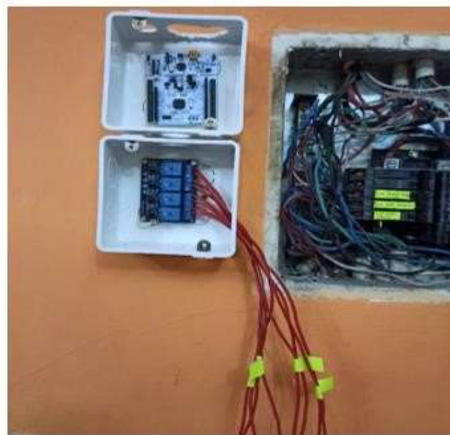
Figura 104 Se encuentra instalado el servidor principal en la residencia y se etiquetaron los cables para identificar cada uno.
