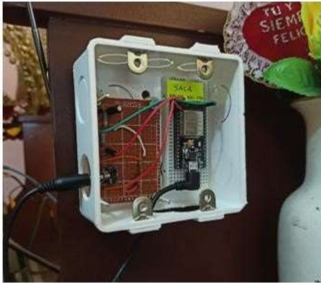
Figura 82 Instalación del sensor1 – sala.
