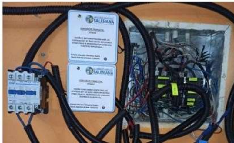
Figura 122 Servidor principal listo para su funcionamiento.
