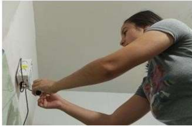
Figura 30 Instalación del sensor 4 – dormitorio
