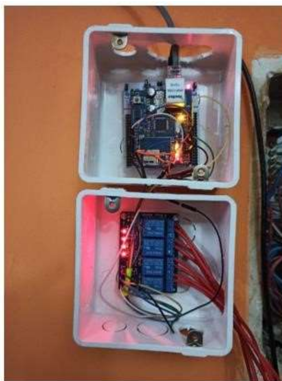
Figura 79 Instalación del servidor principal con un cable de red y alimentación directa a la corriente eléctrica.
