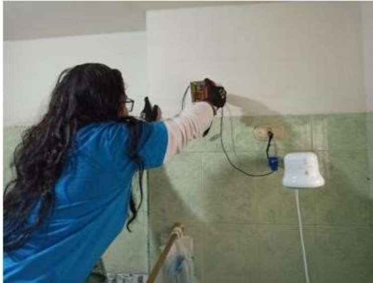
Figura 119 Instalación del sensor 4 – dormitorio.
