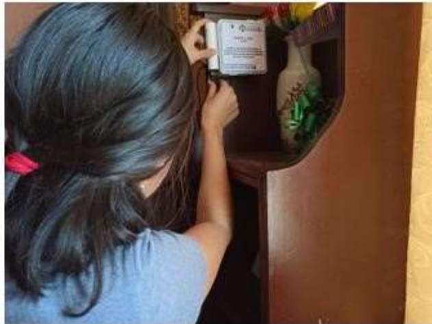
Figura 123 Alimentando el sensor1
