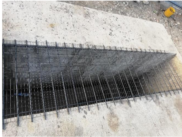
Figura A.2. Parillas de seguridad colocadas en la fosa. Fuente: autores
