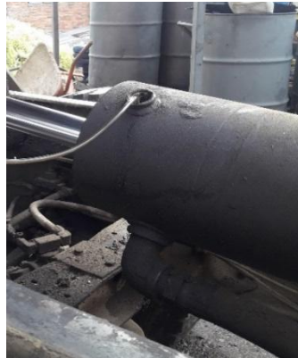
Figura 33: Manguera en el depósito del sistema hidráulico. Fuente: Autores
