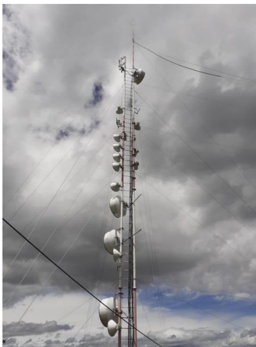
Figura 3. 2. Torre de telecomunicaciones sector Tabacundo
