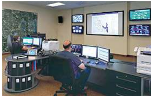
Figura 9: Sistema SCADA supervisado por un operador.
