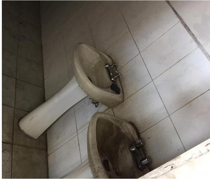
Ilustración 9: Estado actual del baño.
