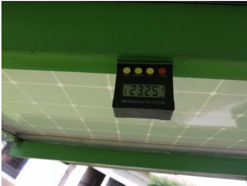
Figura 7. Ángulo de inclinación de los paneles fotovoltaicos ubicados U.P.S.
