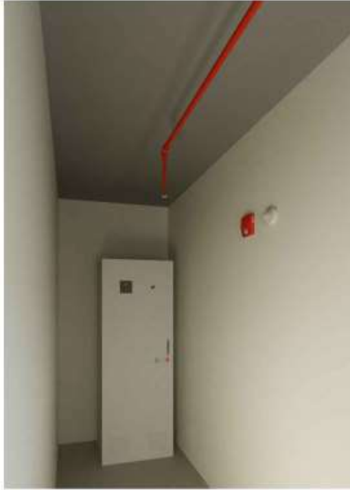
Figura 27. Cuarto de Tableros
