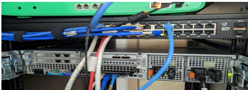
Figura 129 Cableado del servidor DELL POWER EDGE R710.
