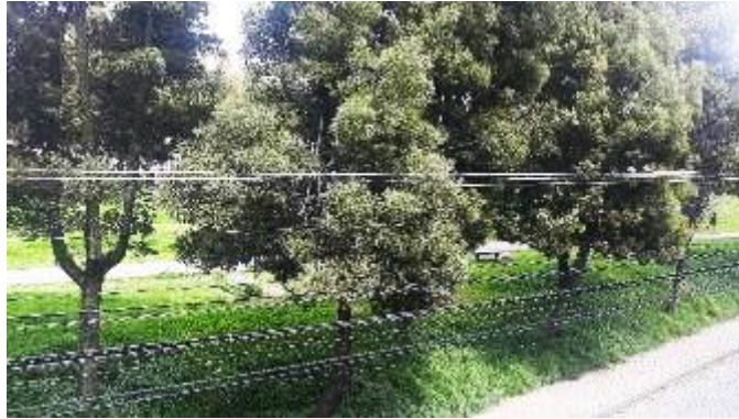
Figura 4.9 Tendido eléctrico sin presencia de palomas
