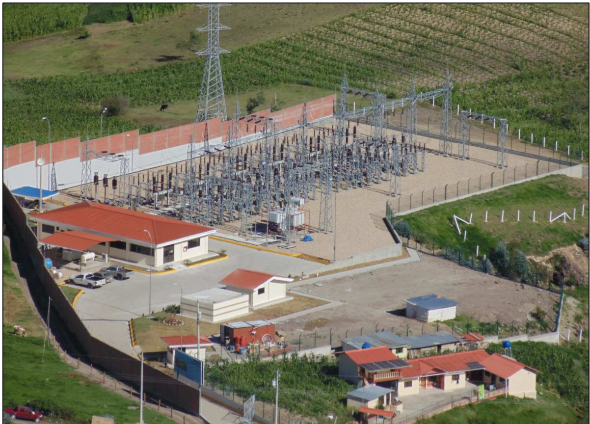
Imagen 1. Vista panorámica de la Subestación Azogues 2 [6]
