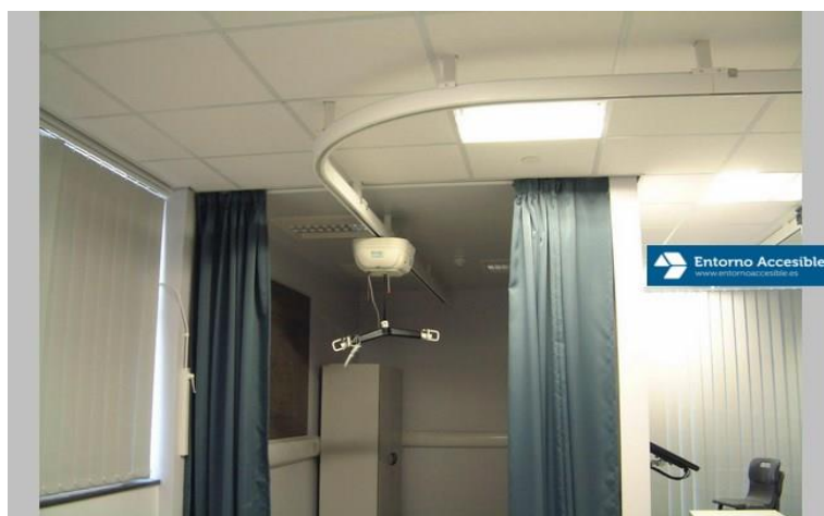
Figura 14: Grúas de techo fijas (Entornoaccesible, 2019)
