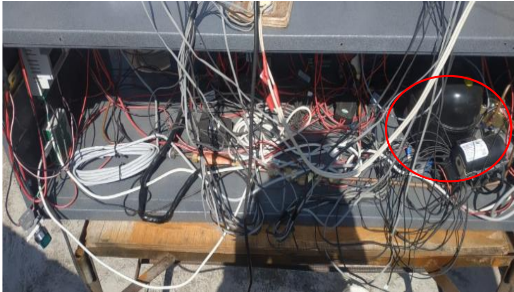
Figura A. 1. Compresor.
