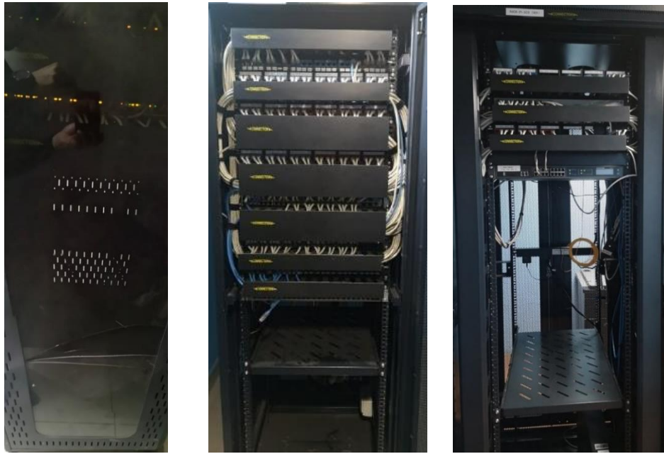
Figura 3.10 Racks de Piso de la Cooperativa
