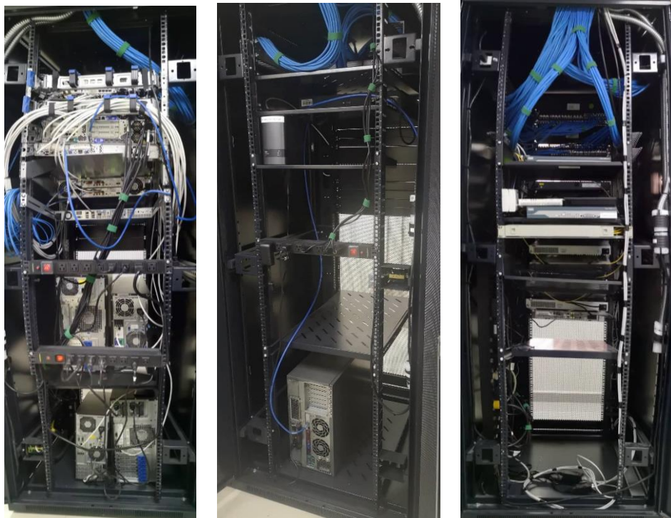
Figura 3.9 Racks existentes en el Data Center
