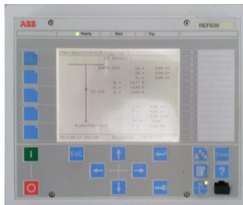
Figura 23. IED ABB de la S/E 1 [52].
