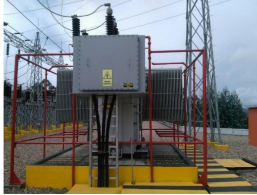
Figura 28. Transformador de Potencia de S/E Azogues 2 [52].
