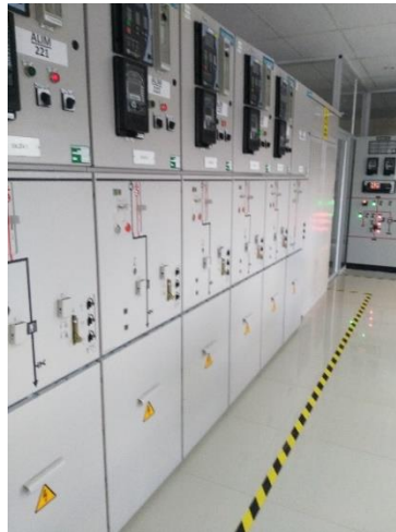
Figura 34. Tableros de Control [52].
