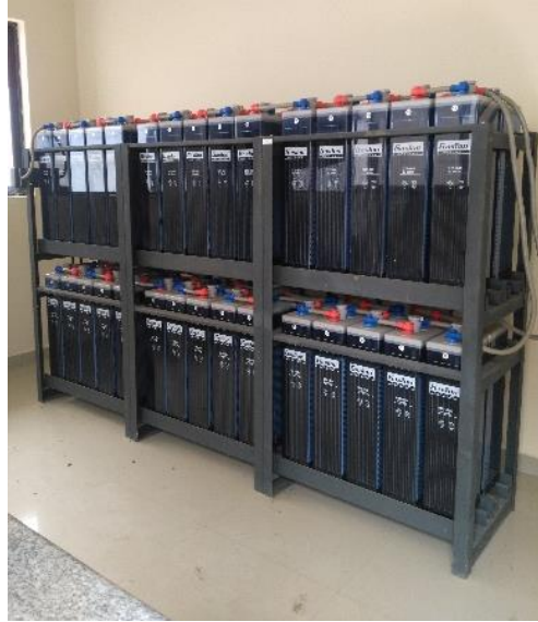
Figura 36. Banco de Baterías [52].
