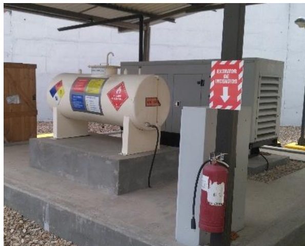
Figura 37. Generador de Emergencia Diesel [52].
