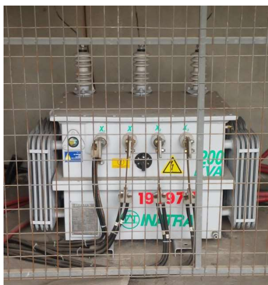
Figura 62. Transformador trifásico 19597P instalado en la cabina de transformación del edificio de Centro de Cómputo. Fuente: Autores
