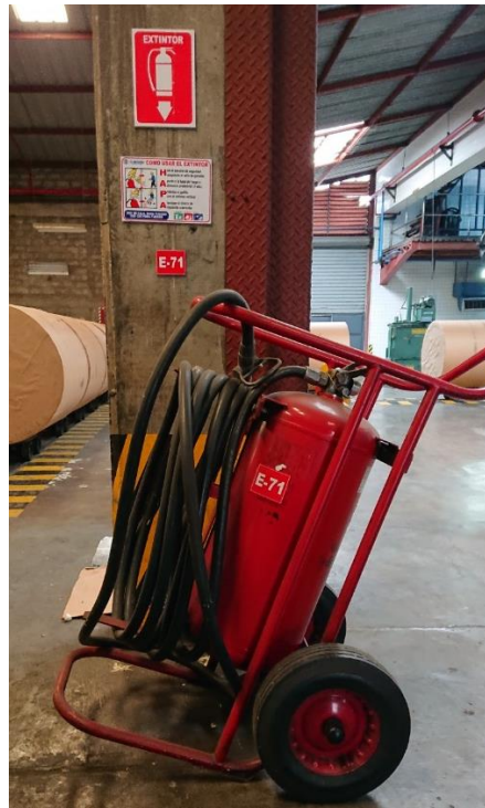
Accesorios contra incendio (hidrantes, gabinete y extintores)
