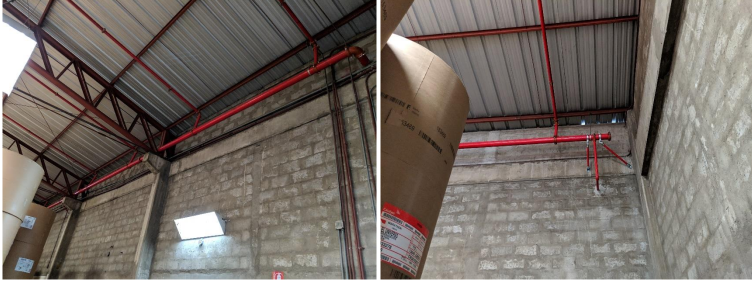
Red de alimentación principal de tuberías 4" y drenaje de tubería 2"
