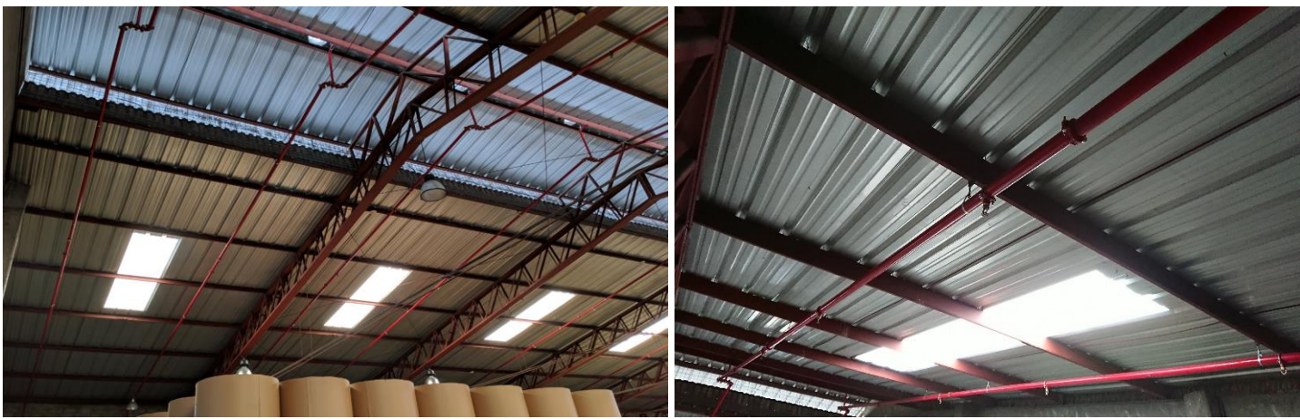
Sistema de red integrada de tuberías 2"
