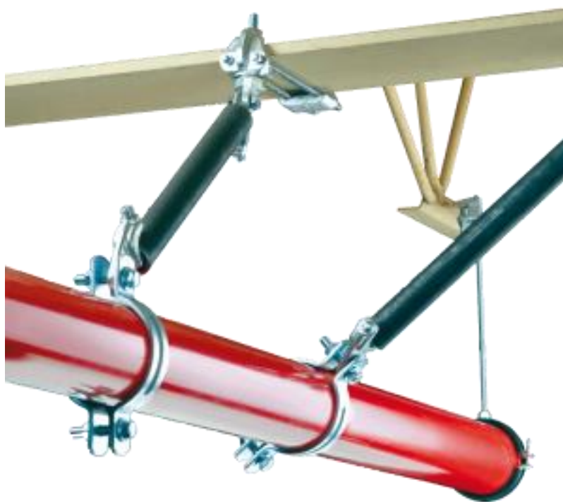
Figura 11 soportes de sujeción y antisísmico (RDfire, 2019)
