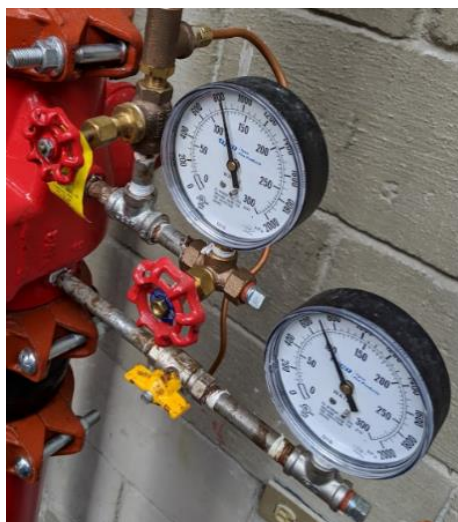
Figura 8 Manómetros de control de presión del sistema de rociadores (tyco, 2018)
