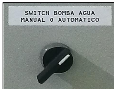
Figura 89. Switch bomba de agua MANUAL / AUTOMATICO
