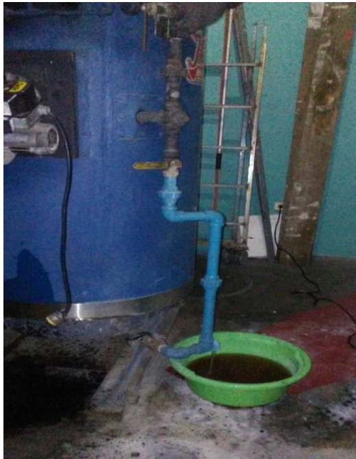
Figura 38. Condiciones anteriores del caldero
