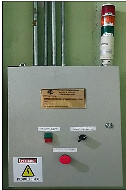
Figura 86. Tablero de control en cuarto de caldero.
