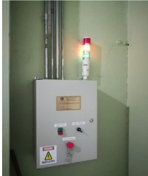
Figura 57. Caldero y bomba encendido tablero 1
