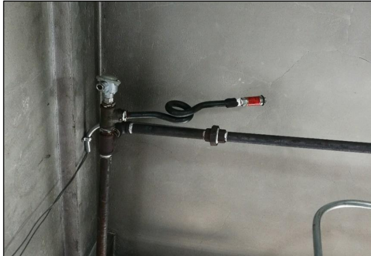
Figura 49. Instalación del Sensor PT100 y transmisor de presión
