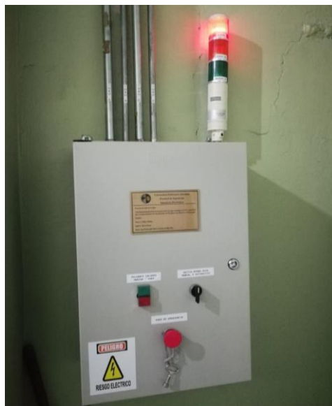
Figura 58. Luz y sirena en cuarto del caldero
