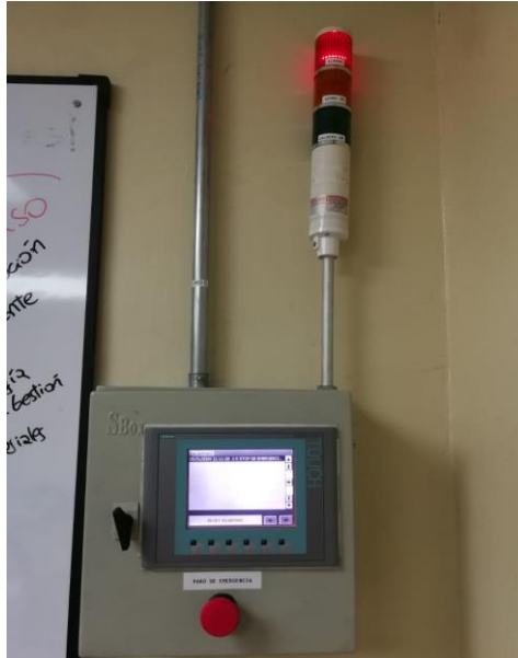
Figura 59. Luz y sirena en oficina de mantenimiento
