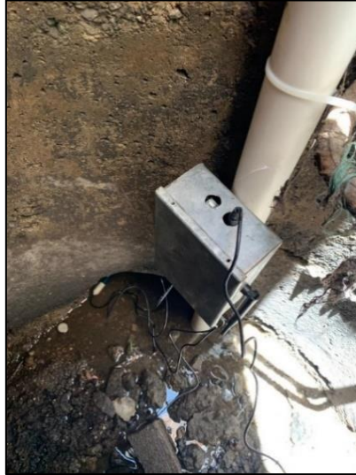
Figura 4-22 Instalación de nodo sensor para la calidad de agua de salida. Fuente: Autores
