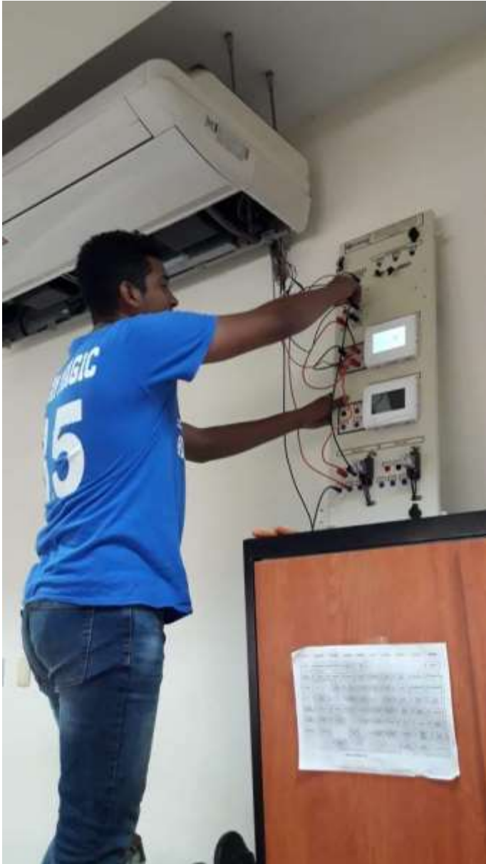
Figura 30. Conexión de módulo al aire acondicionado
