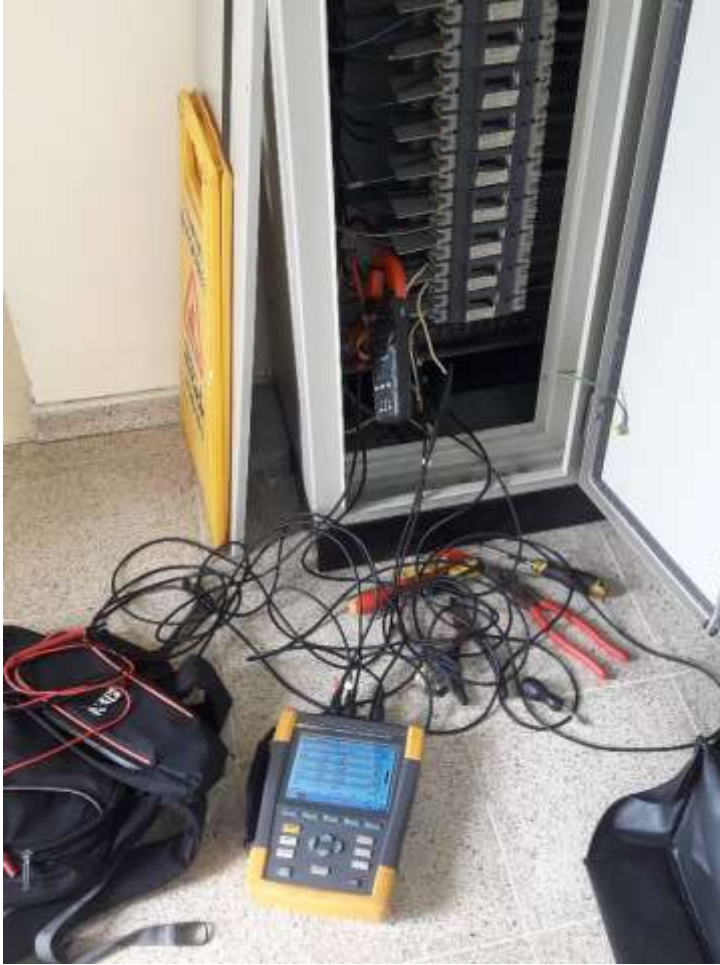
Figura 14. Analizador de Red Fluke 435 Fuente: Los autores
