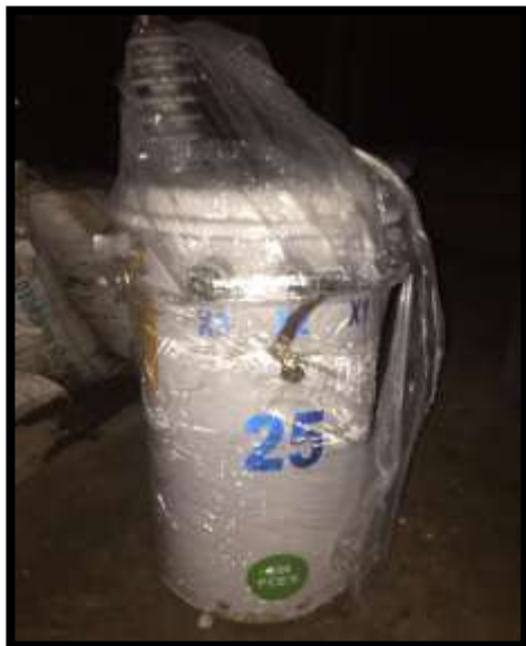
FIGURA 40 TRANSFORMADOR DE CAPACIDAD DE 25 KVA
