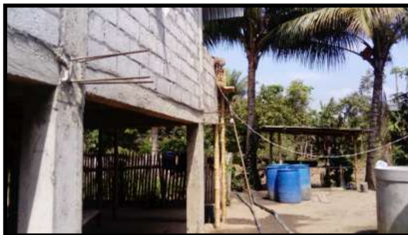
FIGURA 34 INSTALACIÓN DE ACOMETIDA DE GENERADOR EN ESTADO PRECARIO.
