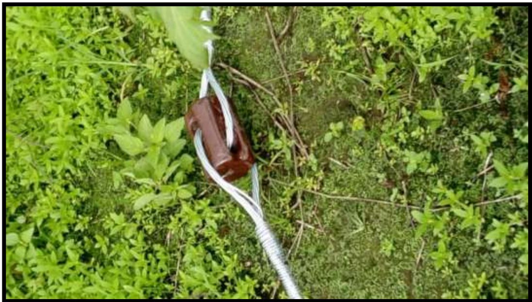
FIGURA 56 AISLADOR DE MEDIA TENSION.
