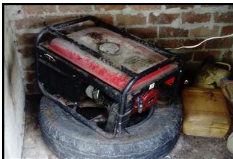
FIGURA 33 GENERADOR ELÉCTRICO MONOFÁSICO.
