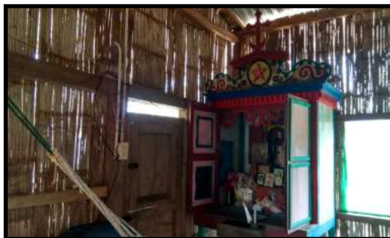
FIGURA 35 INSTALACIONES ELECTRICAS EN EL INTERIOR DEL HOGAR EN PRECARIA CONDICIONES QUE CUENTA CON UN GENERADOR.
