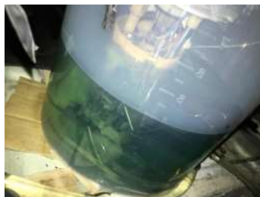
Figura 31. Depósito de combustible. Fuente: Los Autores
