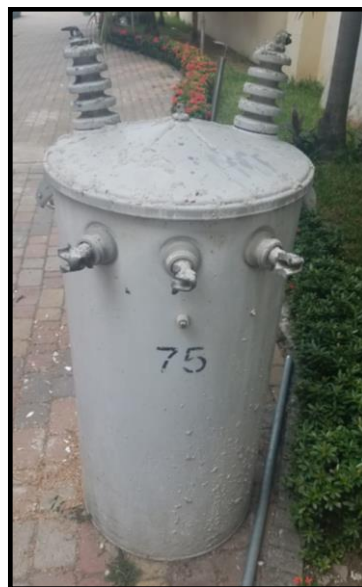
FIGURA 9. TRANSFORMADOR DE DISTRIBUCION 75 KVA. FUENTE: LOS AUTORES.
