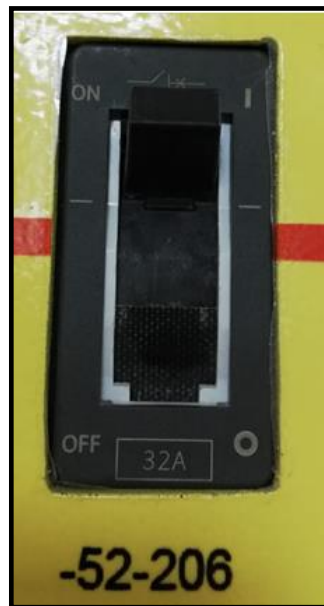
FIGURA 36. INTERRUPTOR TRIFÁSICO 52-206. FUENTE: LOS AUTORES
