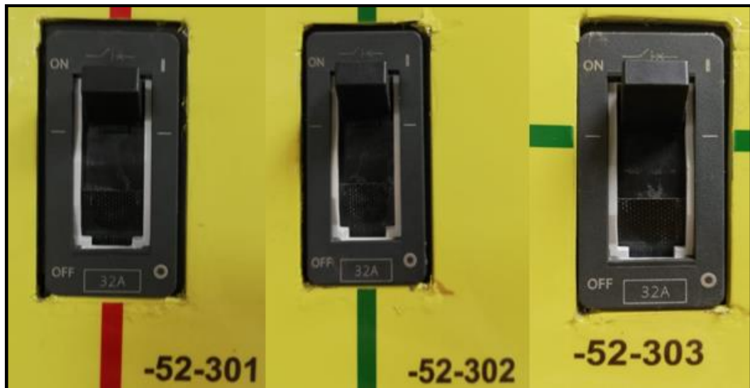
FIGURA 40. INTERRUPTOR TRIFÁSICO 52-301 / 302 / 303. FUENTE: LOS AUTORES
