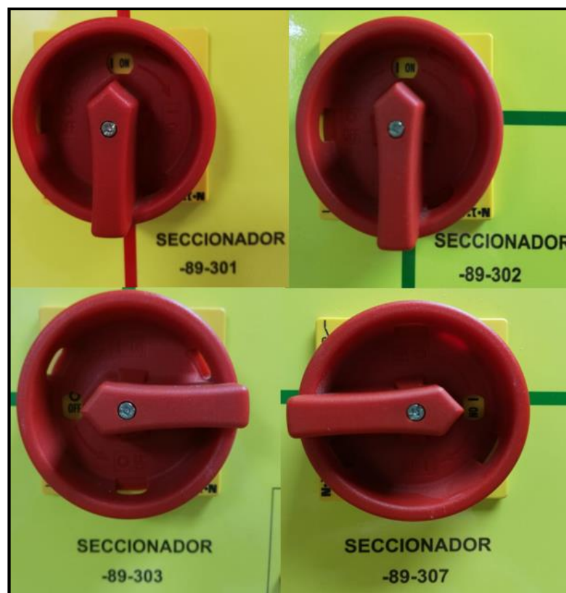
FIGURA 39. SECCIONADOR TRIFÁSICO -89-301 / 302 / 303 / 307. FUENTE: LOS AUTORES.
