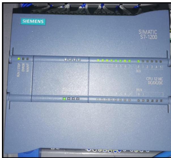
FIGURA 45. PLC S7 1200 DC/DC/DC. FUENTE: LOS AUTORES.
