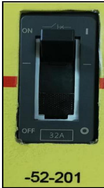
FIGURA 35. INTERRUPTOR TRIFÁSICO 52-201 . FUENTE: LOS AUTORES
