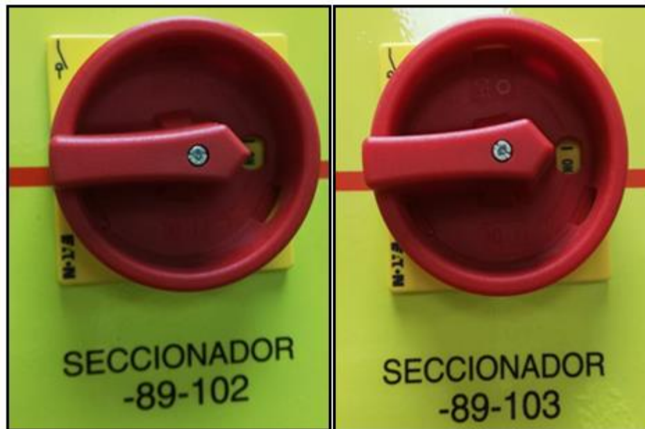
FIGURA 30. SECCIONADOR TRIFÁSICO -89-102 / 103. FUENTE: LOS AUTORES
