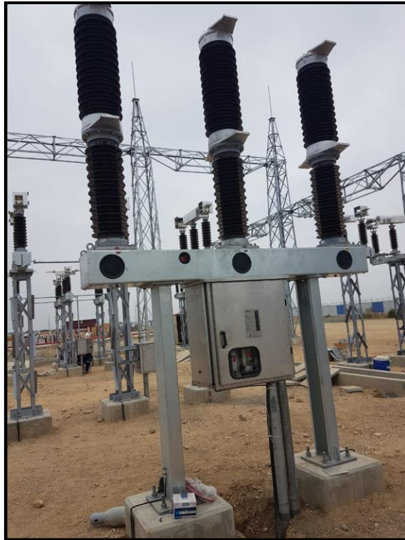
FIGURA 7. INTERRUPTOR 69 KV. FUENTE: LOS AUTORES
