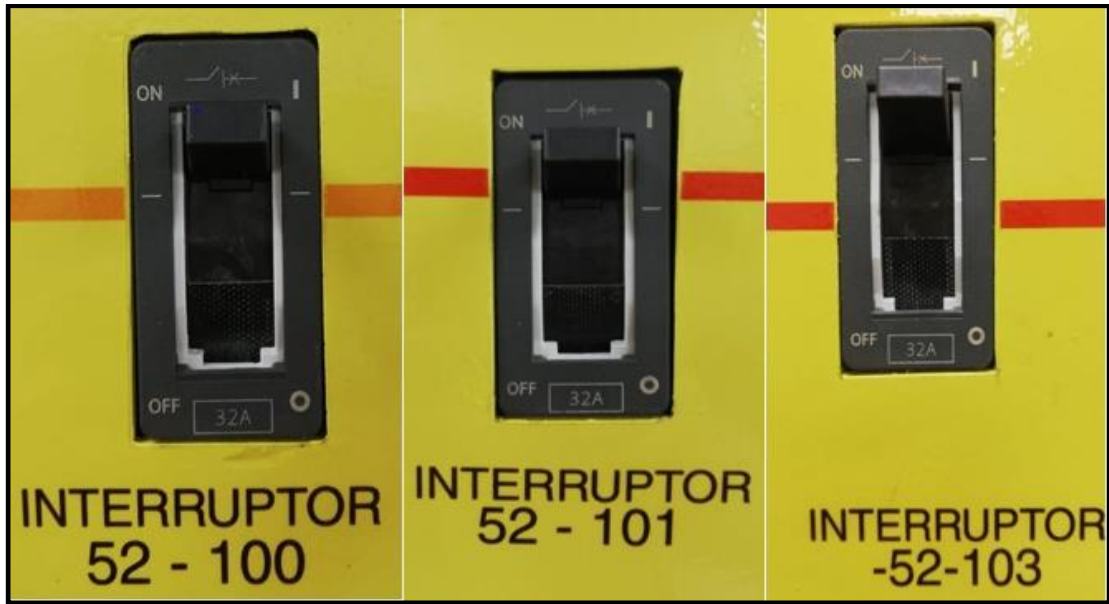
FIGURA 31. INTERRUPTOR TRIFÁSICO 52-100 / 101 / 103. FUENTE: LOS AUTORES
