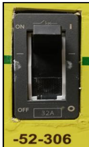
FIGURA 41. INTERRUPTOR TRIFÁSICO 52-306. FUENTE: LOS AUTORES
