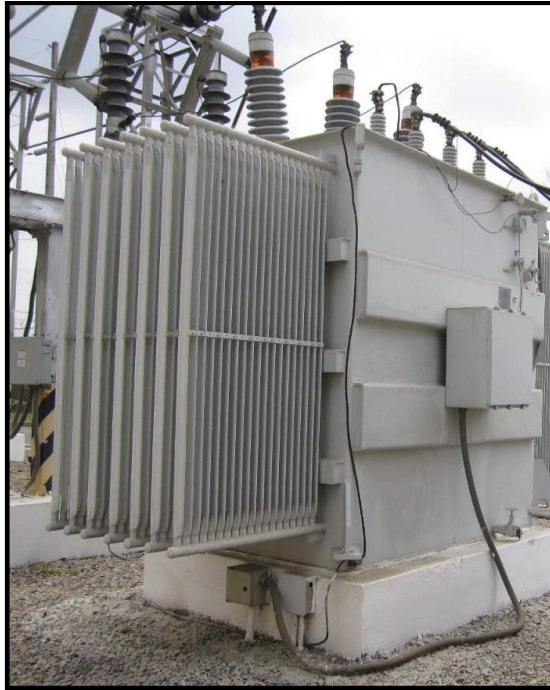
FIGURA 5. TRANSFORMADOR DE POTENCIA. FUENTE: LOS AUTORES
