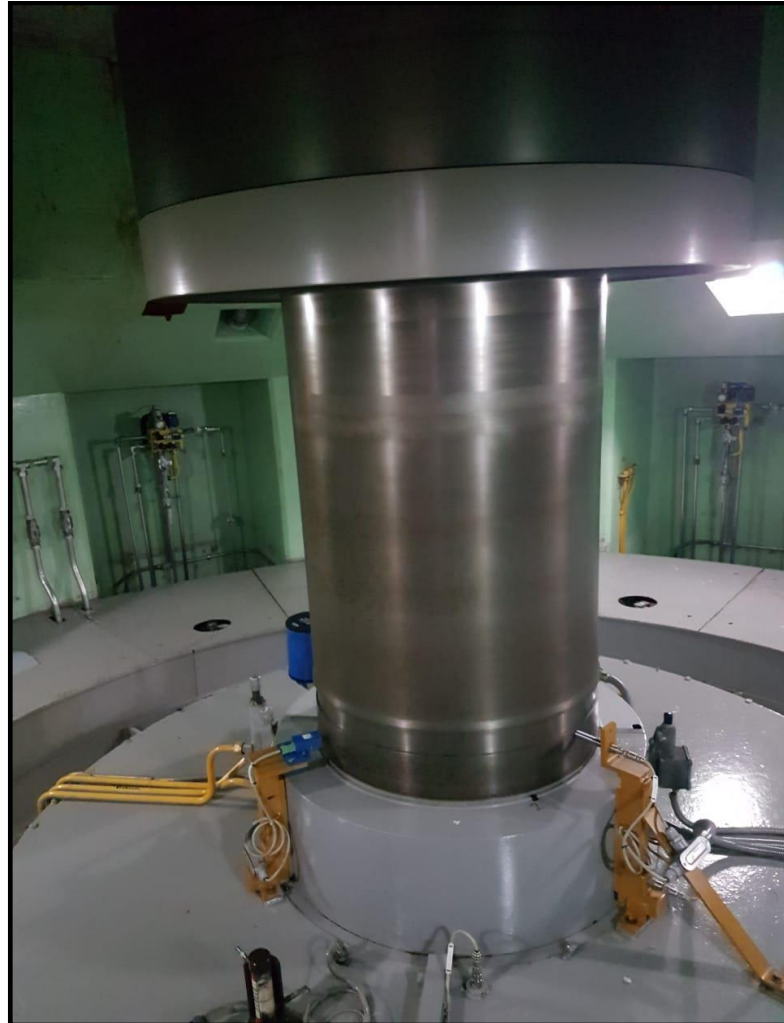
FIGURA 4. TURBINA CENTRAL HIDROELÉCTRICA PAUTE. FUENTE: LOS AUTORES
