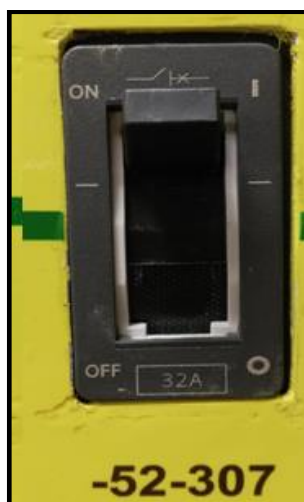
FIGURA 42. INTERRUPTOR TRIFÁSICO 52- 307. FUENTE: LOS AUTORES
