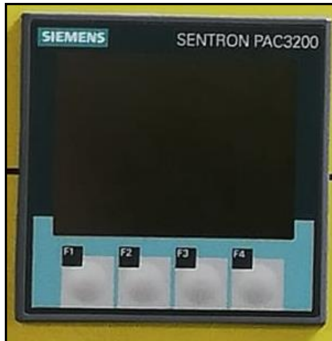
Figura 37. ANALIZADOR DE RED. FUENTE: LOS AUTORES.
