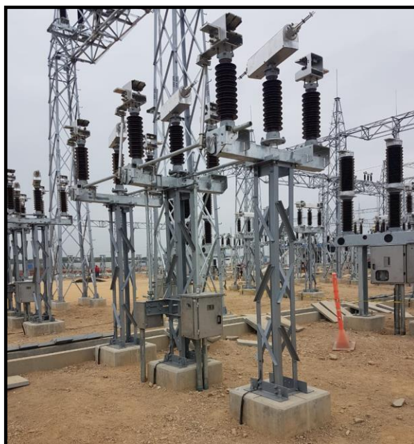
FIGURA 6. SECCIONADORES 69 KV. FUENTE: LOS AUTORES
