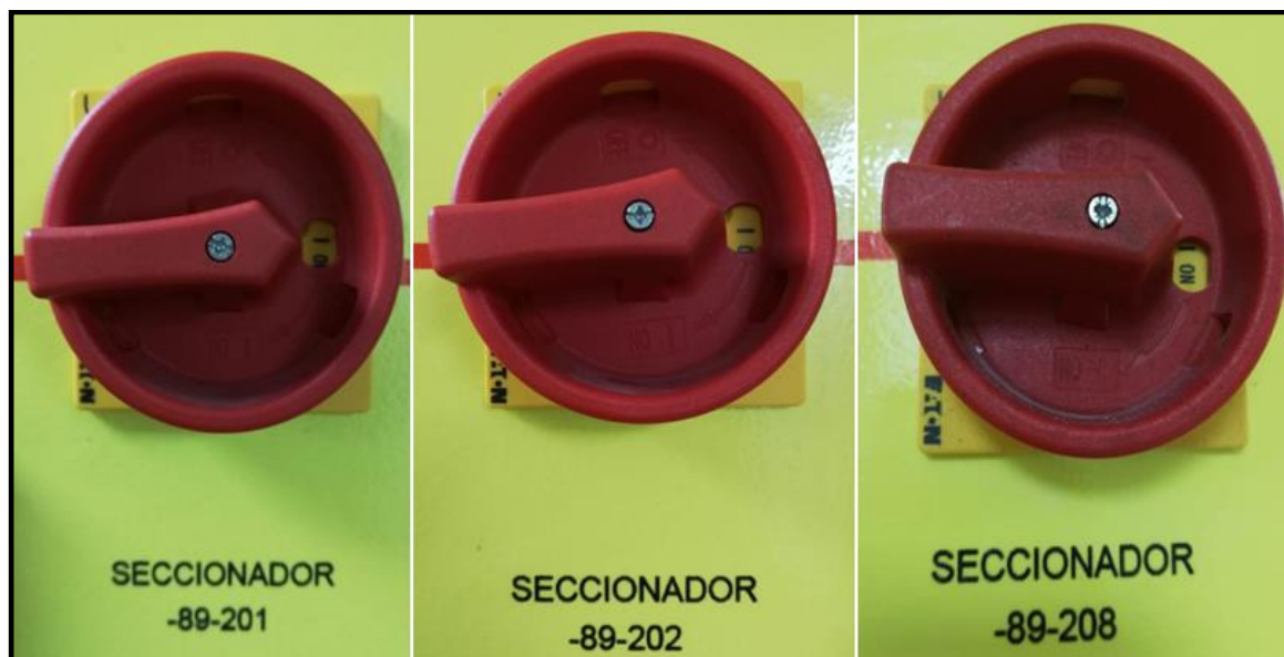
FIGURA 34. SECCIONADOR TRIFÁSICO -89-201 / 202 / 208. FUENTE: LOS AUTORES
