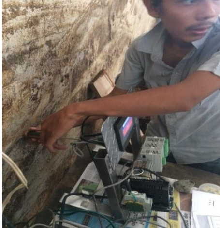
Figura 29: Ajustes del cableado de equipos.
