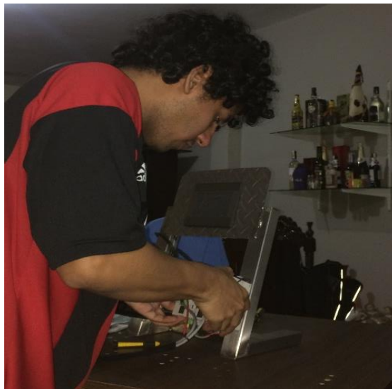
Figura 19: Instalación de módulo de pesaje y PLC.
