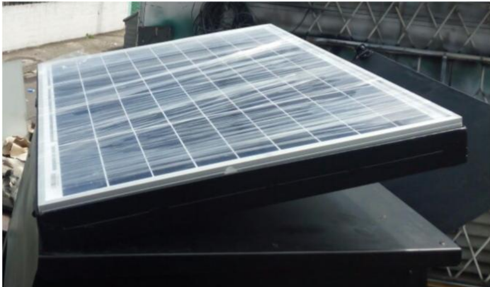
Figura 3.6. Ubicación del panel solar en la estación
