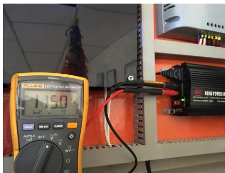
Figura 61. Voltaje medido a la salida del inversor de tensión
