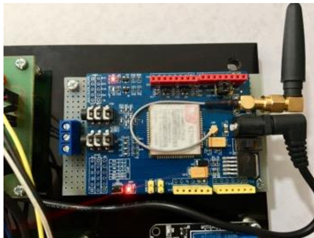
Figura 44. Módulo GSM con SIMCARD instalada
