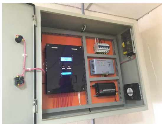
Figura 30. Tablero de control
