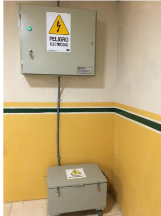
Figura 31. Ubicación del tablero de control en el laboratorio
