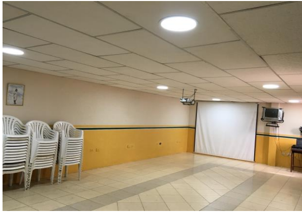
Figura 57. Iluminación actual del laboratorio funcionando
