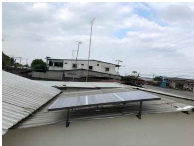
Figura 27. Estructura para módulos fotovoltaicos
