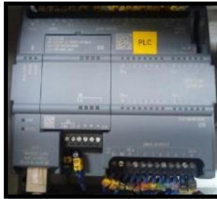
FIGURA 28: CONTROLADOR LÓGICO PROGRAMABLE CPU 1214C DC/DC/DC
