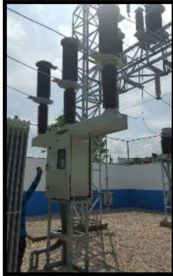
FIGURA 6: INTERRUPTOR EN 69 KV
