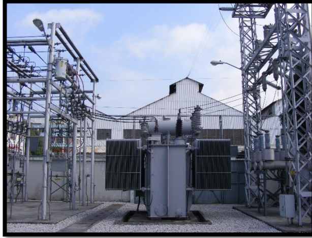
FIGURA 1: SUBESTACIÓN EL ASTILLERO CNEL GUAYAQUIL
