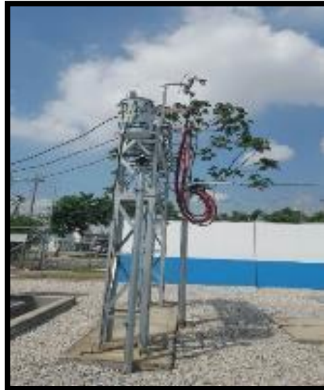
FIGURA 12: TRANSFORMADOR EN ESTRUCTURA DE 13.8 kV
