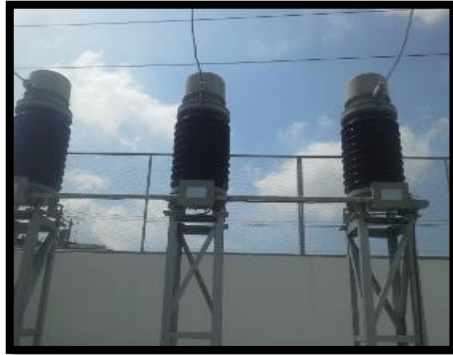
FIGURA 10: PT'S EN EL LADO DE 69 kV
