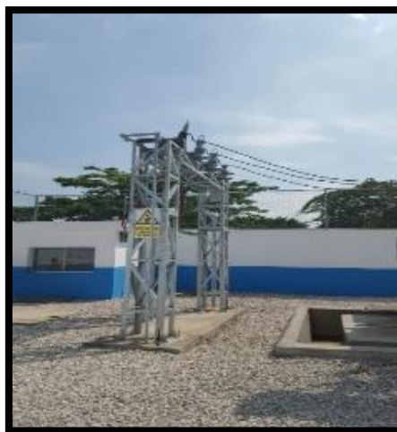
FIGURA 11: PT'S EN EL LADO DE 13.8 KV
