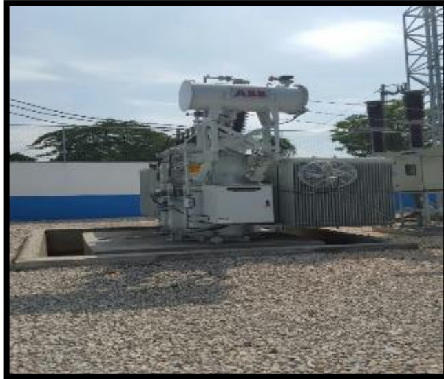
FIGURA 7: TRANSFORMADOR DE PODER SUBESTACIÓN HOSP. TEODORO MALDONADO
