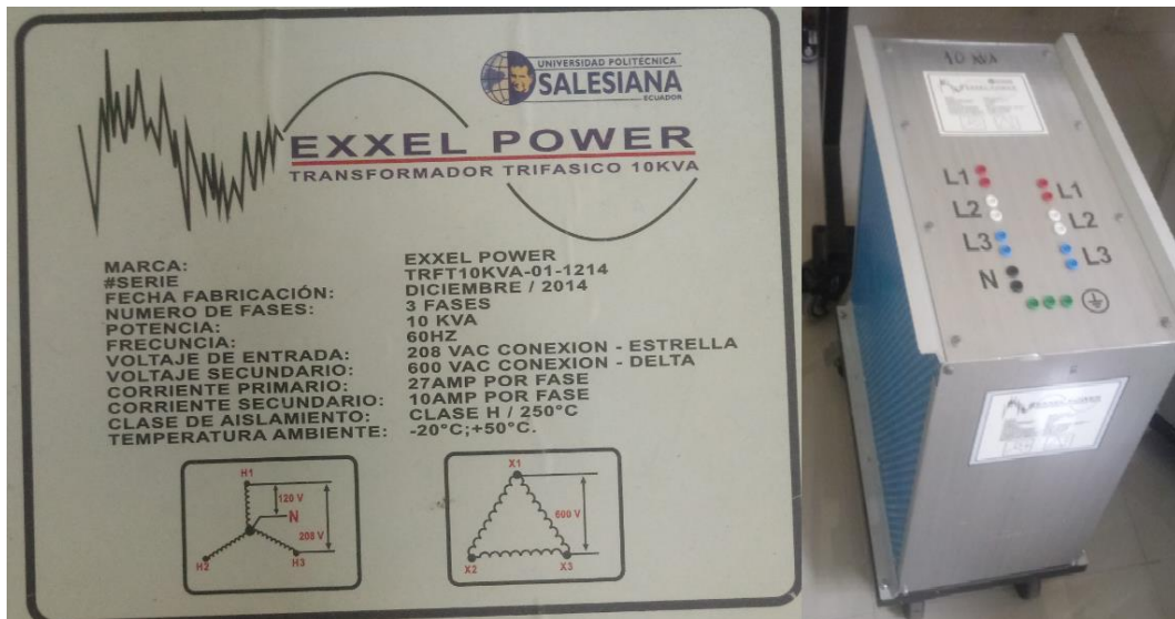
FIGURA 45: TRANSFORMADOR TRIFÁSICO DE 10 KVA Y SU RESPECTIVA PLACA
