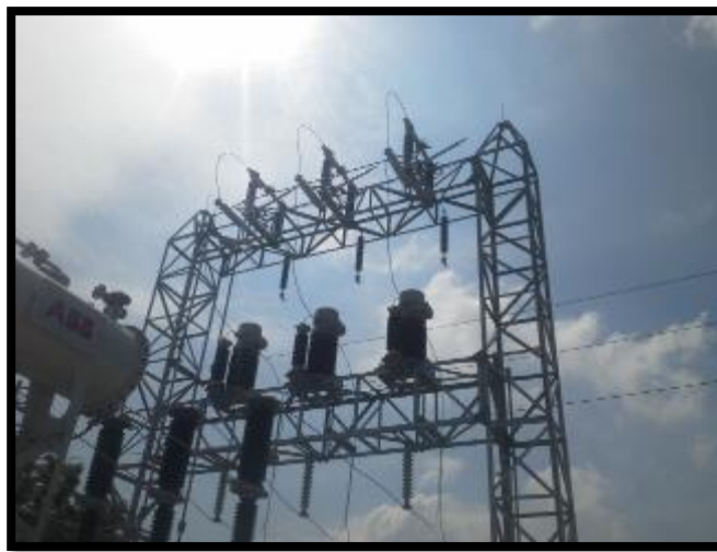
FIGURA 5: SECCIONADORES EN 69 KV
