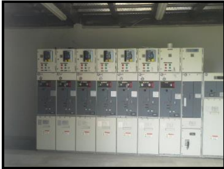
FIGURA 13: CELDAS EN 13.8 KV
