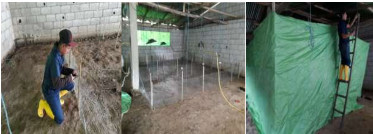
Figura 21. División de los tratamientos, y colocación del micro clima dentro de la nave.
