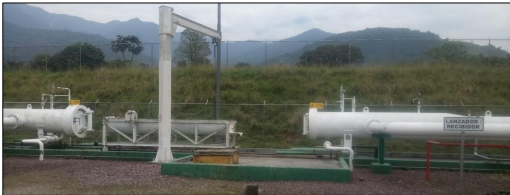
Figura 2. 15 Área de Lanzamiento y Recepción de PS3
