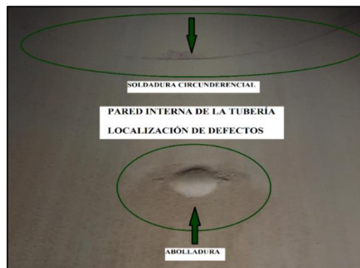
Defectos en la pared interna de la tubería. Elaborado por: Andrea Boada.
