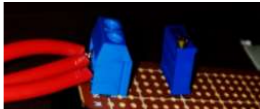
Figura 3.9. Placa PCB convertidor de corriente a voltaje
