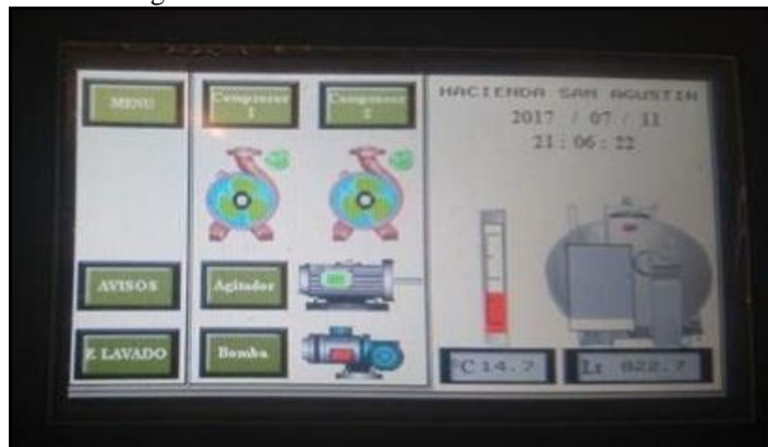
Figura 4.23 Inicio de sistema de enfriamiento.
