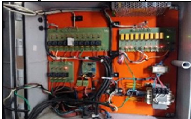
Figura 4.20 Conexión de fuente y placas
