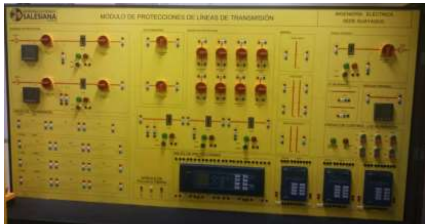
FIGURA 69 TABLERO CON LOS ELEMENTOS MONTADOS, FUENTE: LOS AUTORES.
