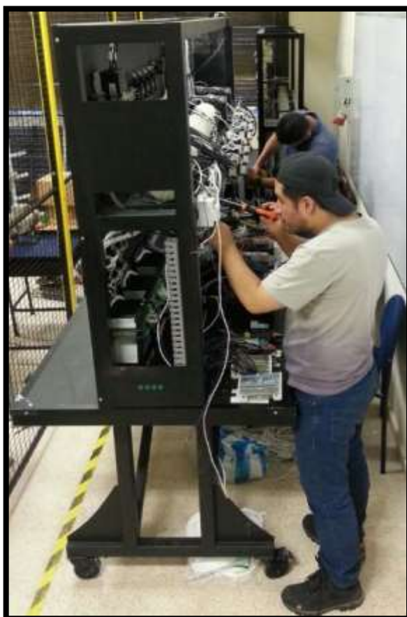
FIGURA 71 CABLEADO DE LOS EQUIPOS DE FUERZA Y CONTROL, FUENTE: LOS AUTORES.
