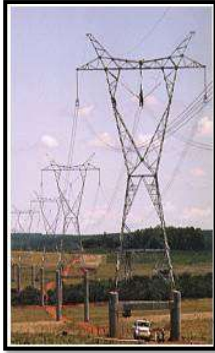
FIGURA 15 LÍNEAS DE TRANSMISIÓN SOBRE ESTRUCTURA METÁLICA [8].
