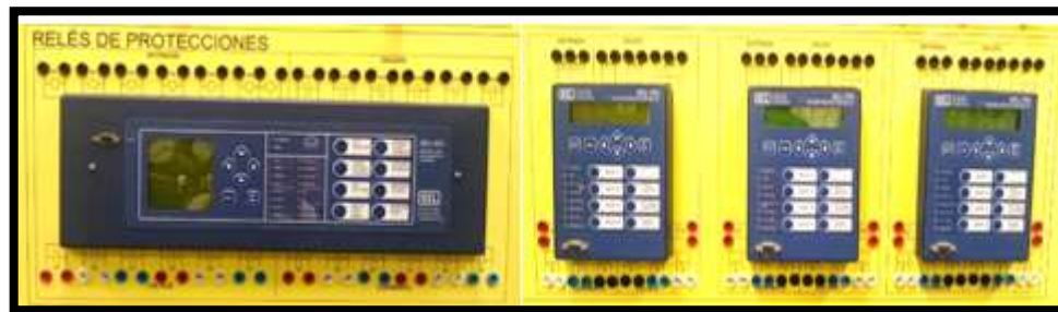
FIGURA 119 RELES DE PROTECCIONES, FUENTE: LOS AUTORES.
