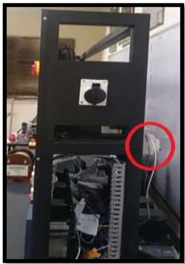
FIGURA 115 UBICACIÓN BREAKER QUE HABILITA EL CONTROL, FUENTE: LOS AUTORES.
