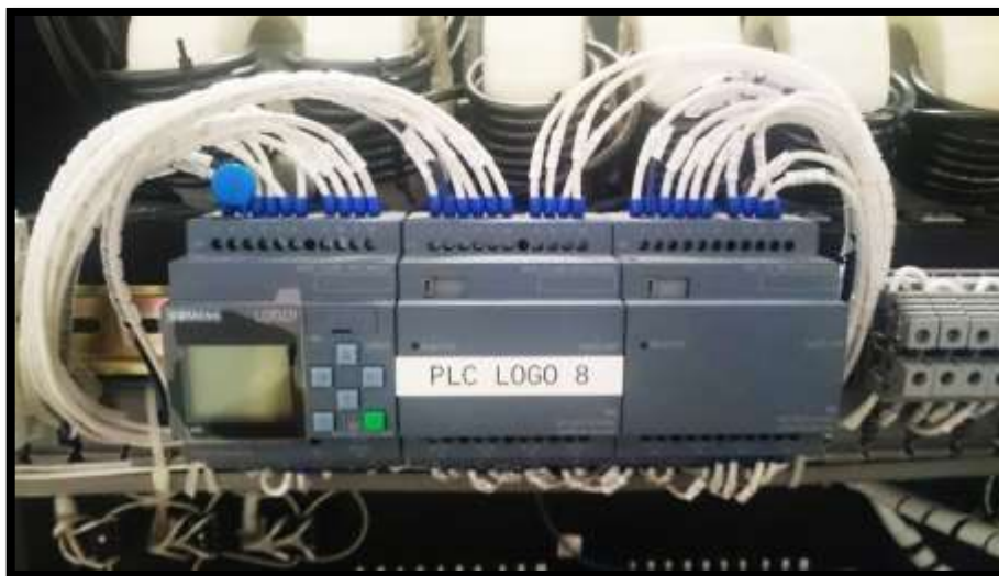
FIGURA 72 CABLEADO DEL SISTEMA DE CONTROL, FUENTE: LOS AUTORES.
